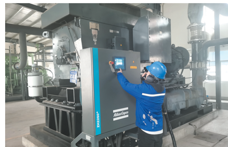
荣成气体生产车间满负荷运转
