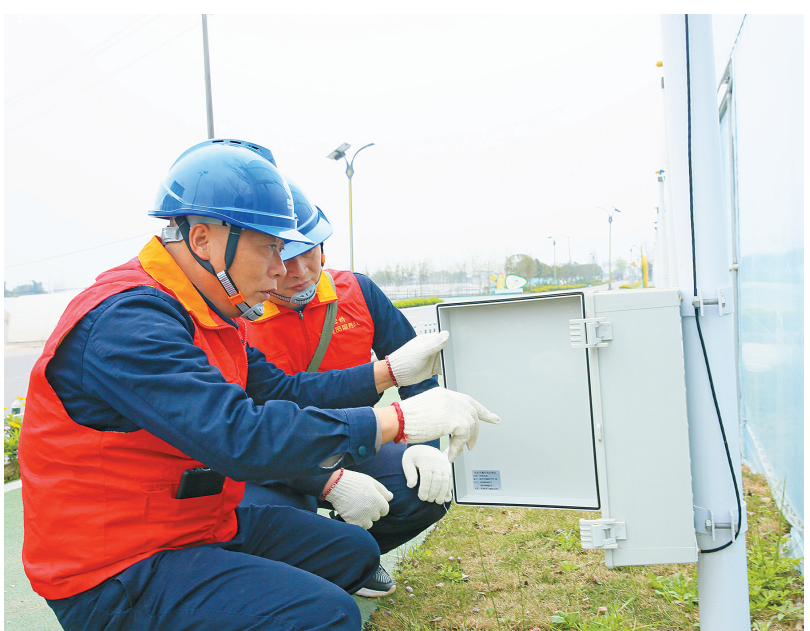
检查园区供电设备
