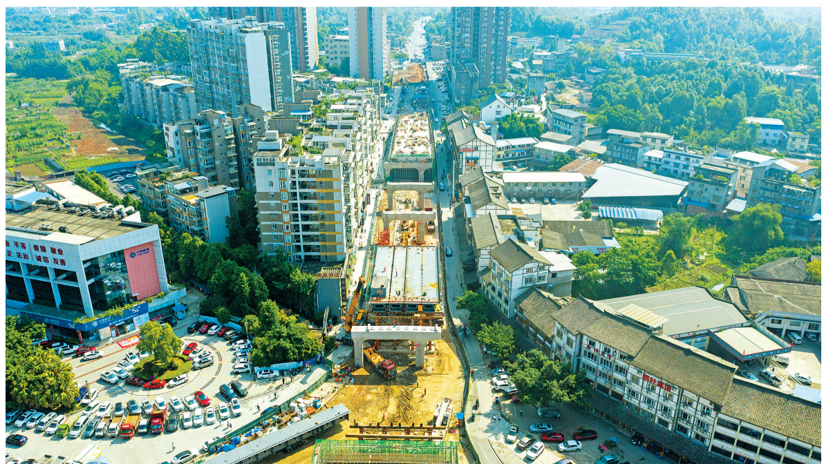
高速乐山城区连接线工程二期(全福连接线)工程建设如火如荼
