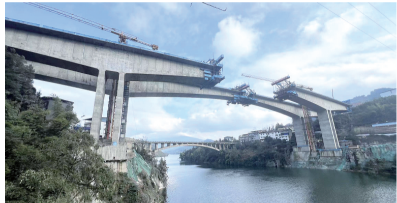
乐西高速马边水库特大桥左线合龙 中铁乐西高速公路有限公司供图
