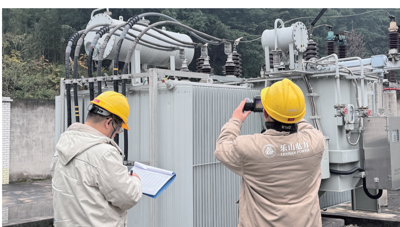
检测电力设备
