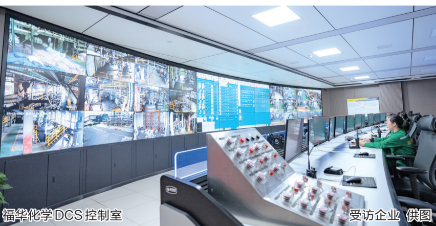
福华化学DCS控制室
