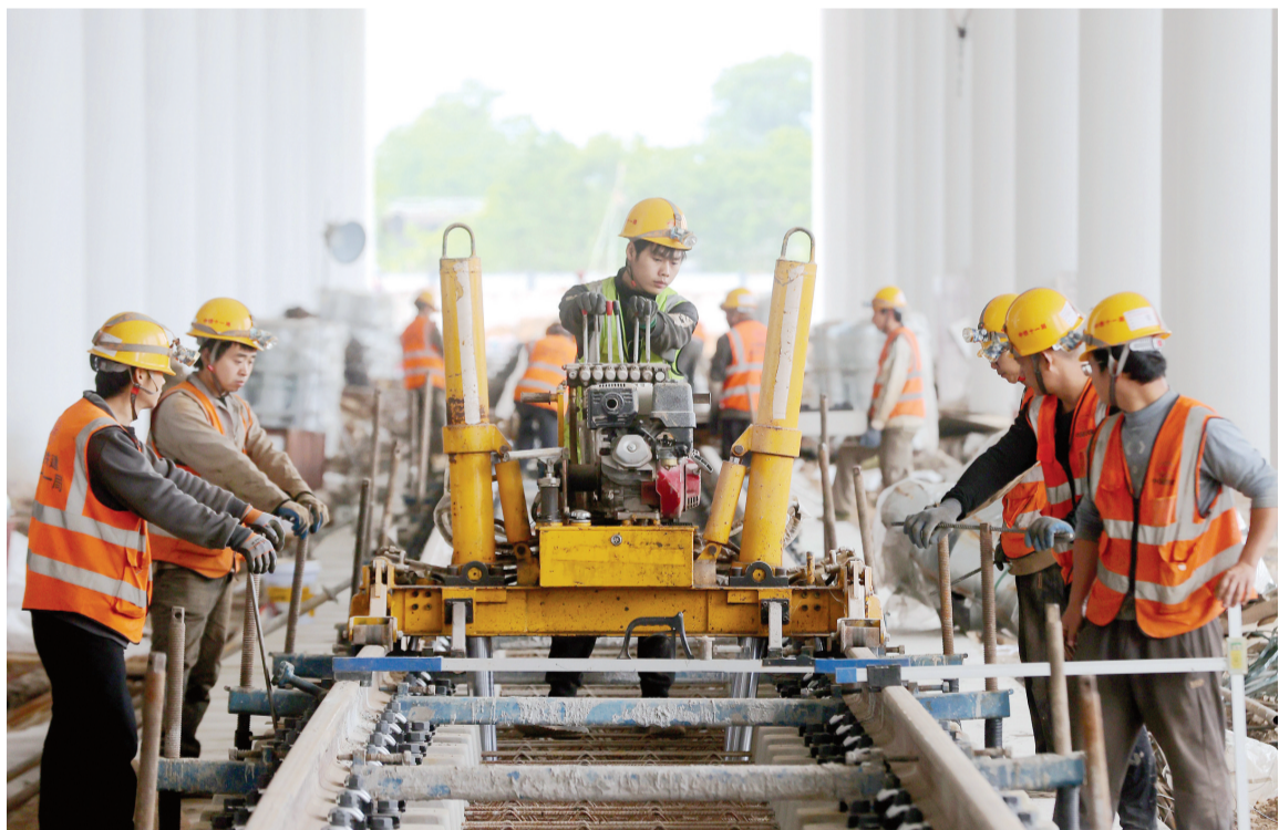
5月3日,中铁十一局建设者在浙江省湖州市德清县杭德市域铁路舞阳车辆基地进行轨道组装起道作业。新华社发(谢尚国 摄)
