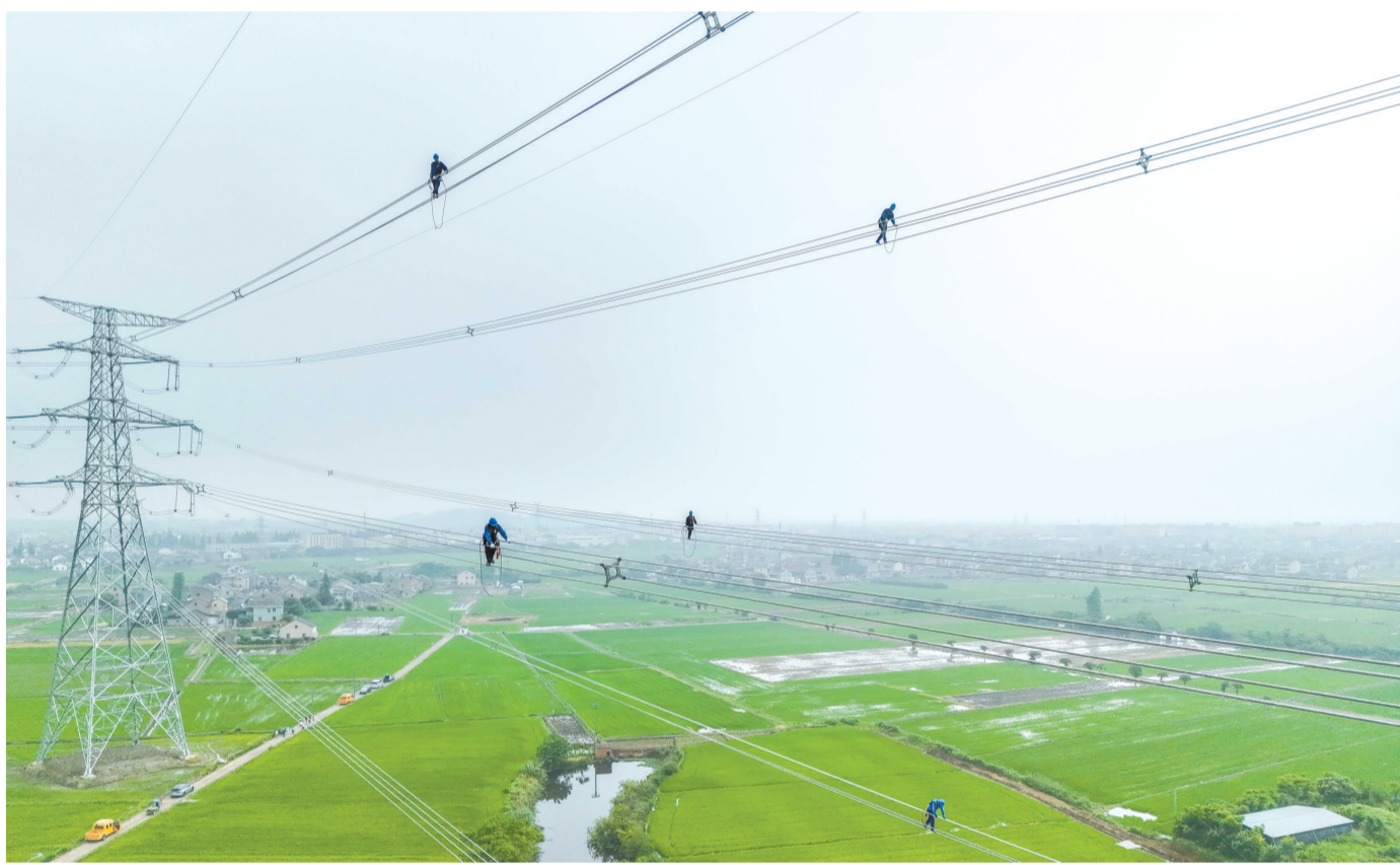
5月22日,甘肃-浙江±800千伏特高压直流输电工程受端500千伏配套工程迎来关键节点,首条送出线路——换流站-春晖双回、换流站-明州双回500千伏线路实现全线贯通。该线路投运后,将进一步增强浙江宁波、绍兴地区电网支撑能力,为清洁能源入浙提供保障。
