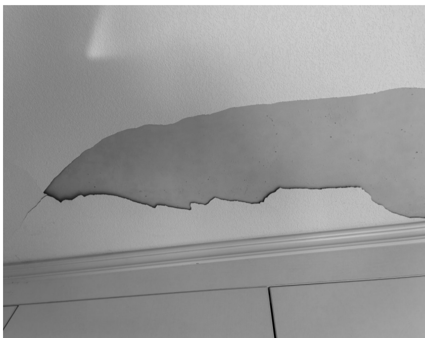
屋顶墙皮脱落。
